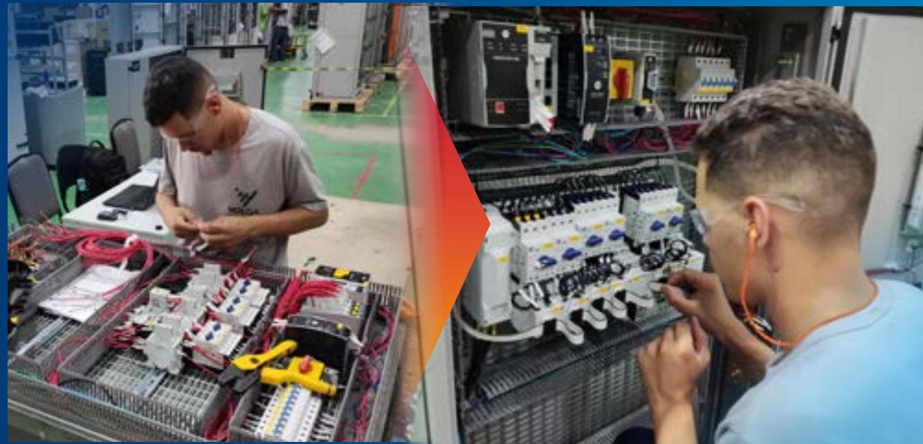
Panel tradicional con lógica cableada Más de 20 horas para cablear
